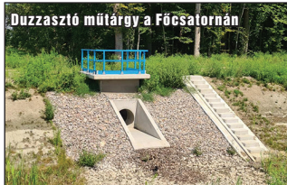
Duzzasztó műtárgy a Főcsatornán
